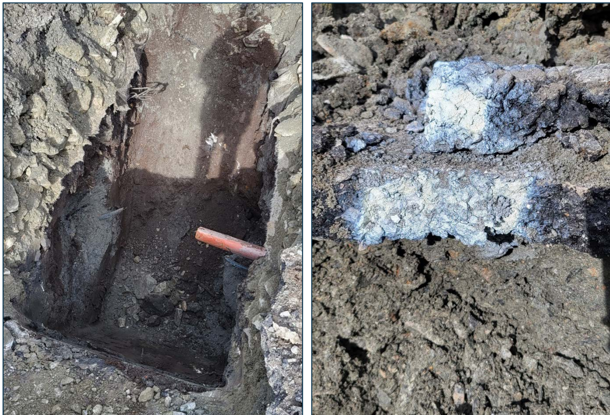
Figur 5. PG2208 (tv) med organiskt rik fyllning och asfalt (th) som ej ger indikation med spray.
